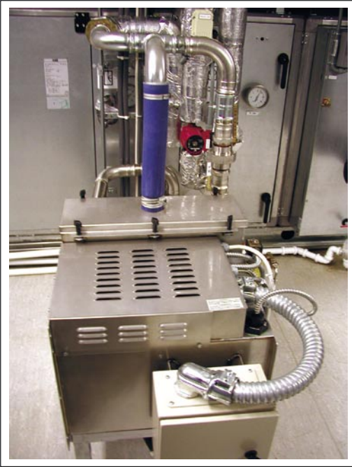
Das VAPORSTREAM Modell VLC-9-1 installiert im Rikshospital, Oslo
